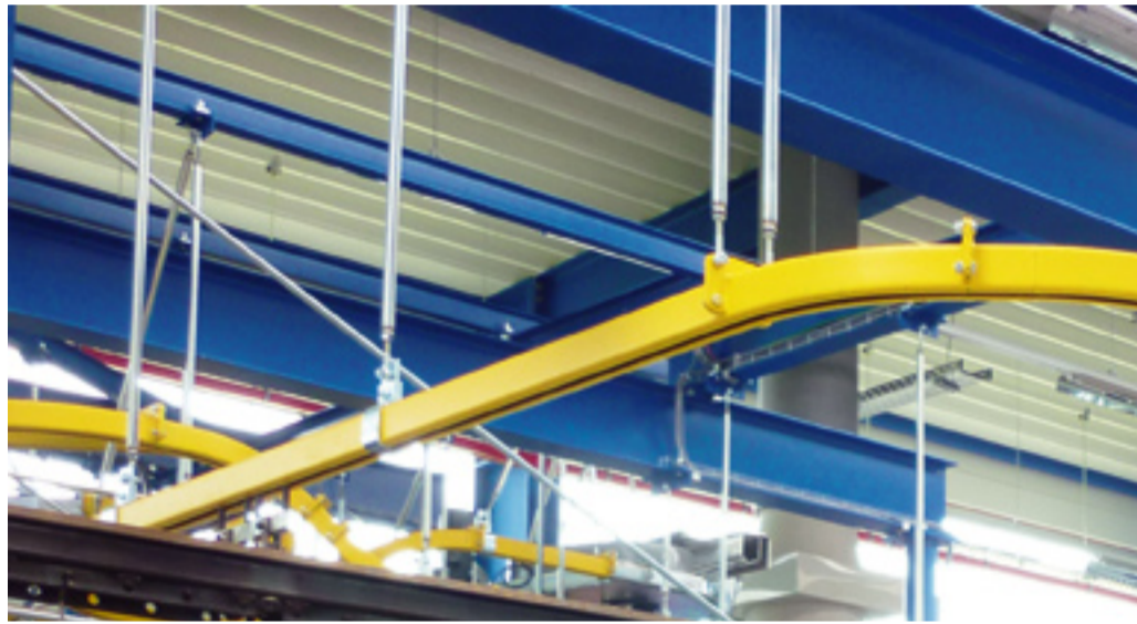
Das Fördersystem der neuen Pulverbeschichtung unterteilt sich in einen Automatikbereich (Vorbehandlung und Trockner) und einen manuellen mit Handschiebebahn.
